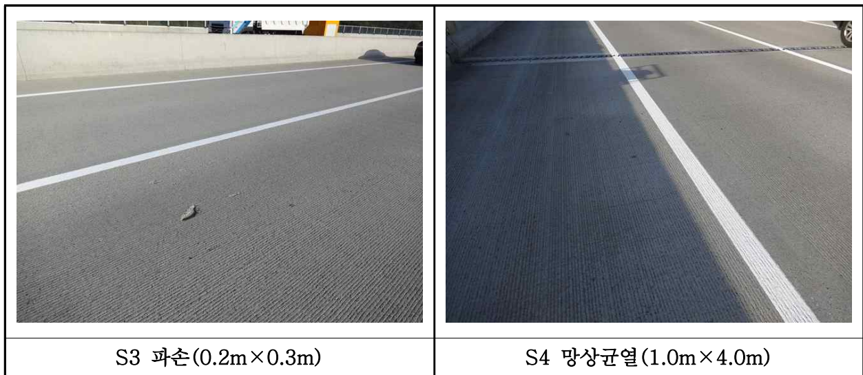
【사진 11.3.45】 교면포장 손상현황
