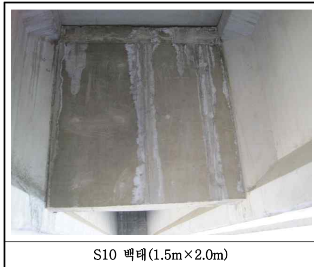
【사진 11.3.7】 가로보 손상현황
