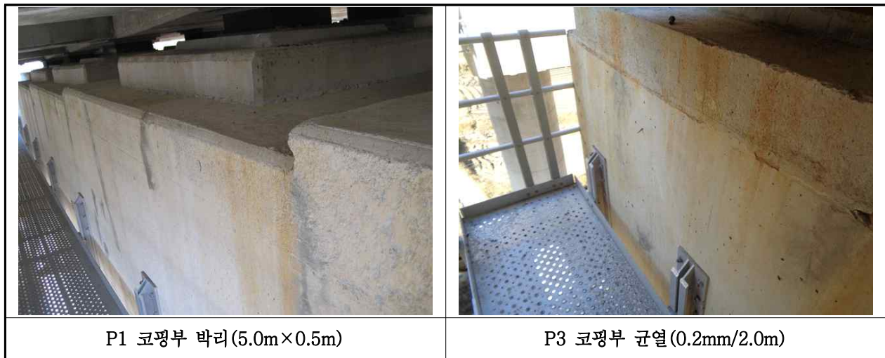
【사진 11.3.11】 교각 손상현황
