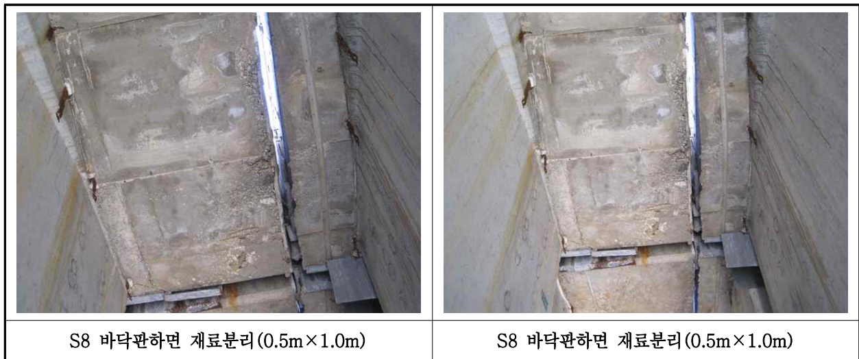
【사진 11.3.3】 바닥판하면 손상현황
