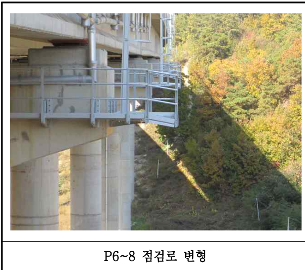
【사진 11.3.26】 교량 점검시설 손상현황
